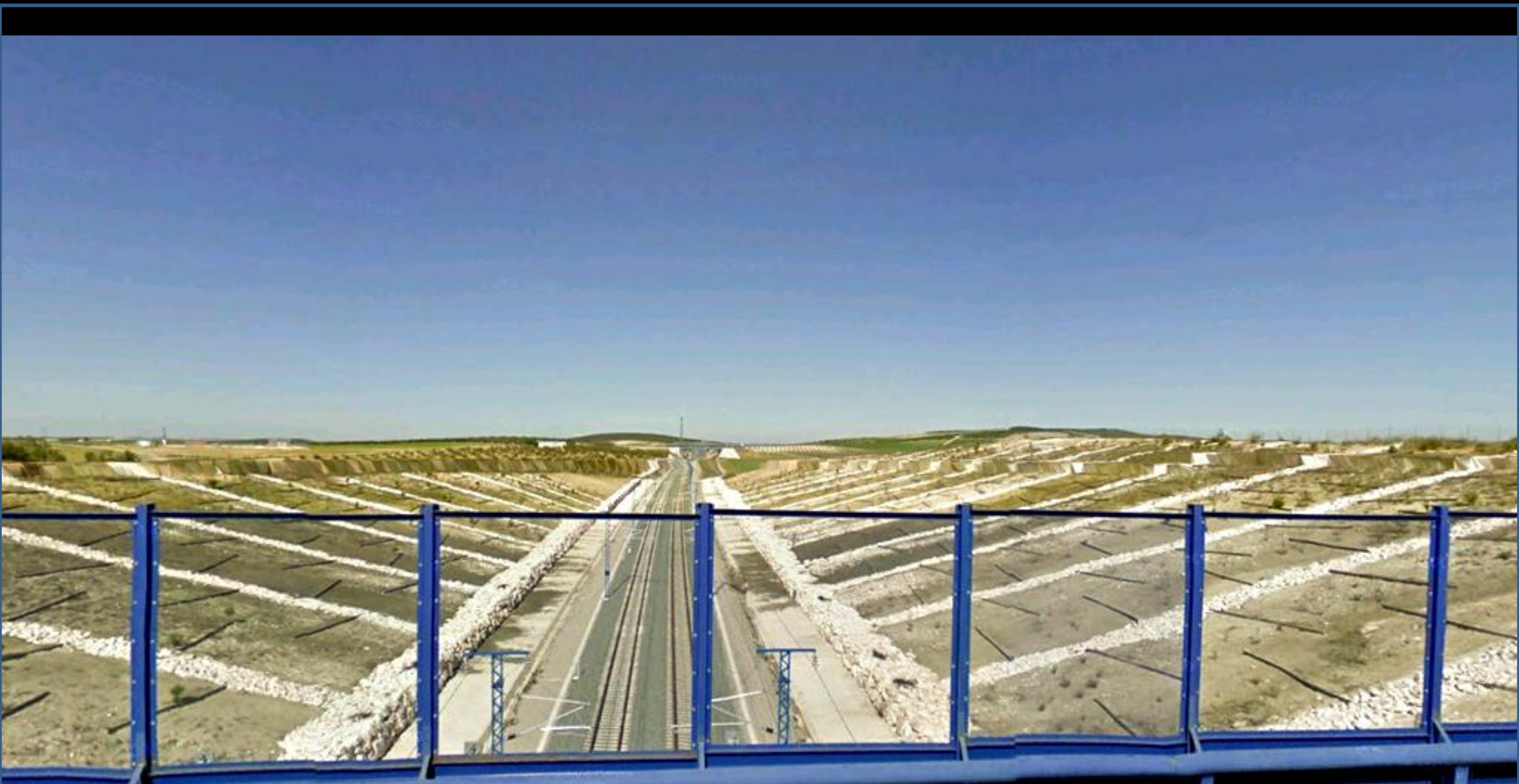
Estabilización de taludes de materiales arcillosos del Triásico. E Cortijo del Ingeniero, NE Hoja de El Rubio, Córdoba.
