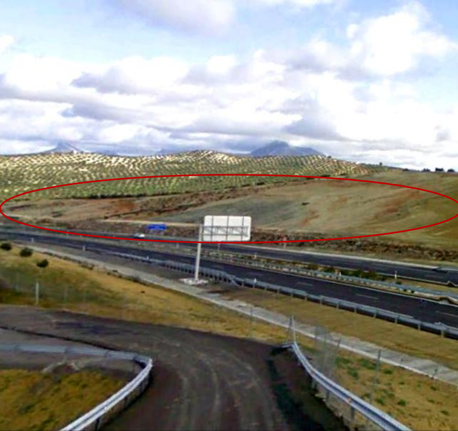
Zona de deslizamientos en la A-45. Primeros movimientos. NW Hoja de Rute, Córdoba. N de Encinas Reales. (por Gabriel Campos-Google)
